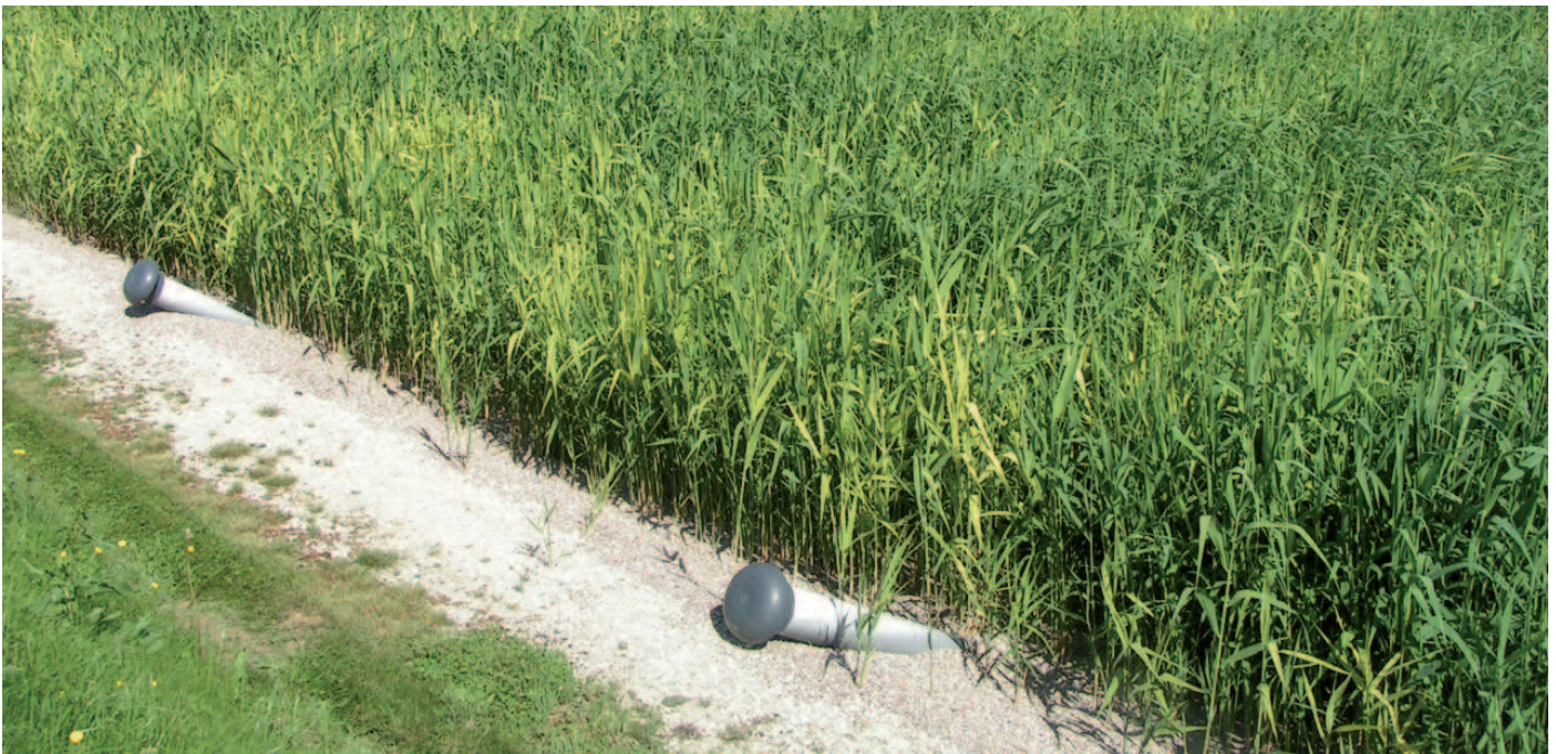
Exemple d'une station de type filtres plantés de roseaux
